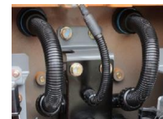
スリットレス電気配線
