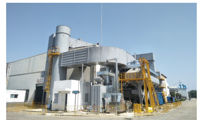
日立建機（中国）のVOCガス浄化・脱臭装置設備
