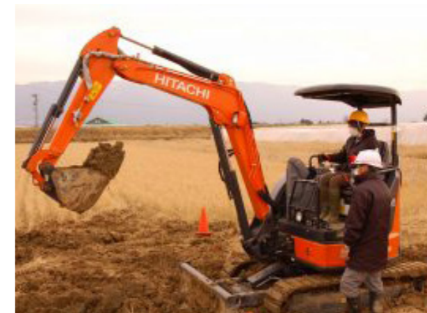
ミニショベルによる復旧作業の実技講習(福岡県朝倉市)
